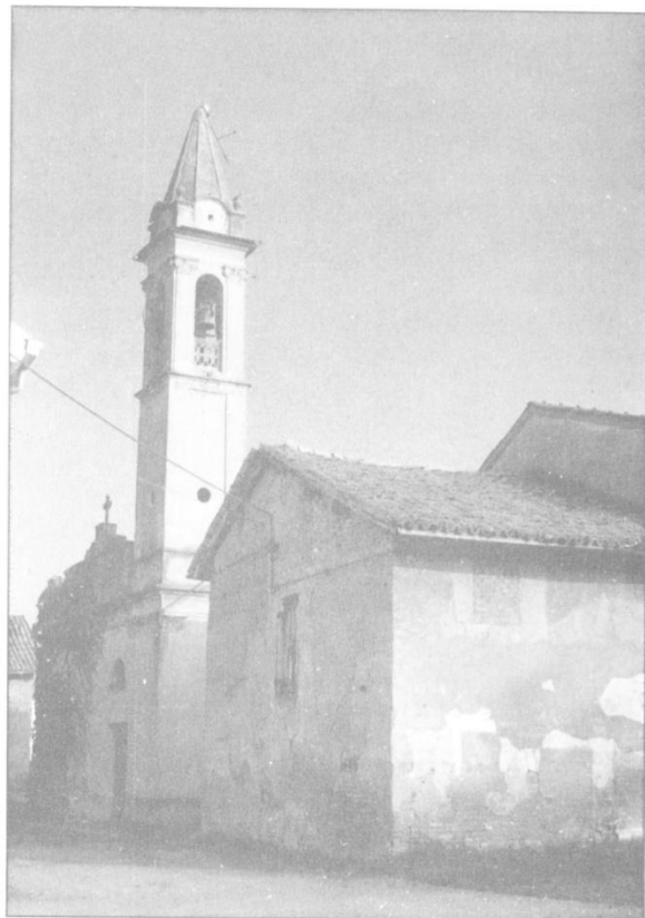
Foto 4.12 - Chiesa. Levata, il fronte principale e il campanile sono intonacati, ma sul fianco è visibile la terra battuta.
